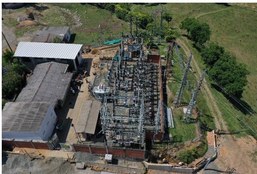
*Vista aérea Subestación Anserma (Anserma – Caldas)
