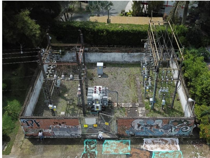
*Vista aérea Subestación Campestre (Dosquebradas – Risaralda)
