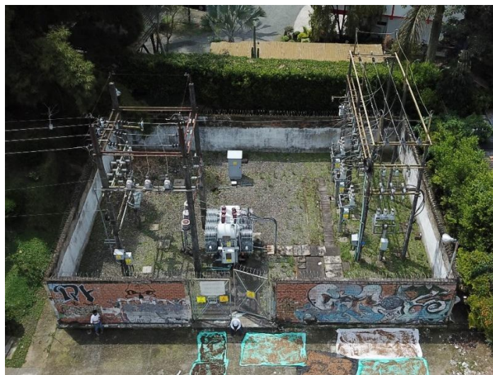
*Vista aérea Subestación Campestre (Dosquebradas – Risaralda)
