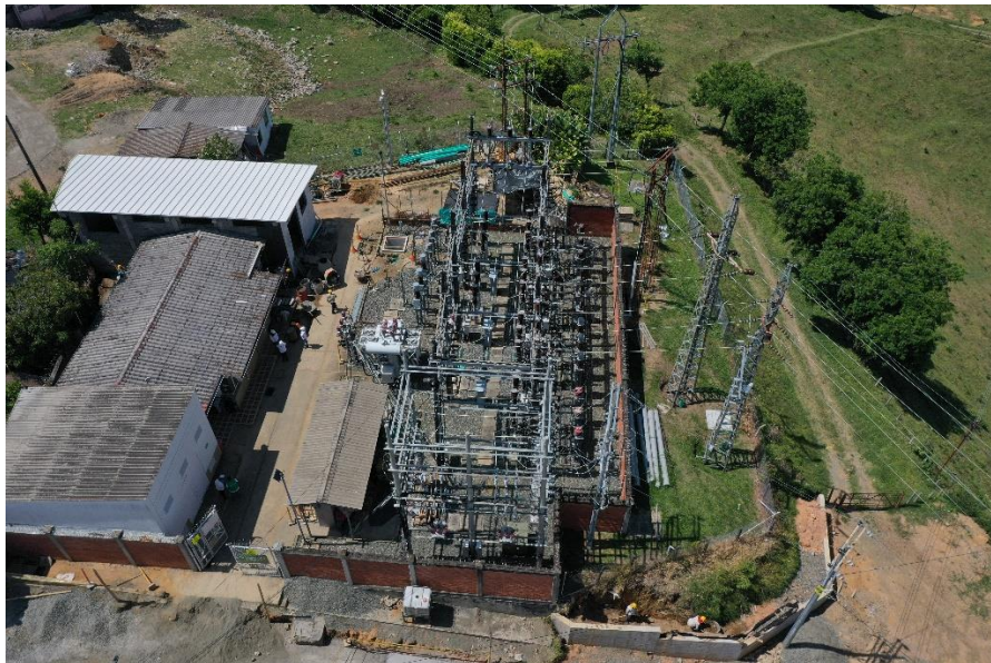
*Vista aérea Subestación Anserma (Anserma – Caldas)
