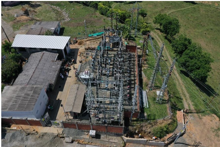
*Vista aérea Subestación Anserma (Anserma – Caldas)
