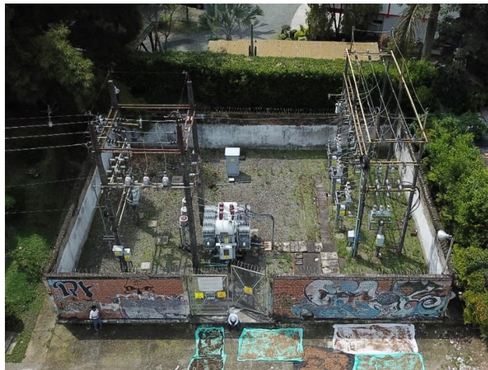
*Vista aérea Subestación Campestre (Dosquebradas – Risaralda)
