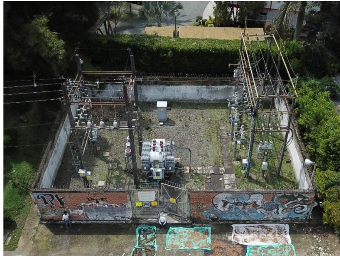
*Vista aérea Subestación Campestre (Dosquebradas – Risaralda)
