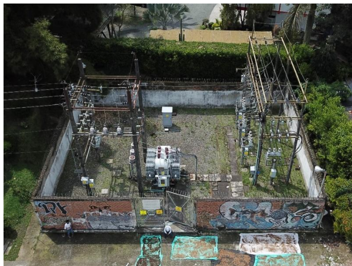
*Vista aérea Subestación Campestre (Dosquebradas – Risaralda)
