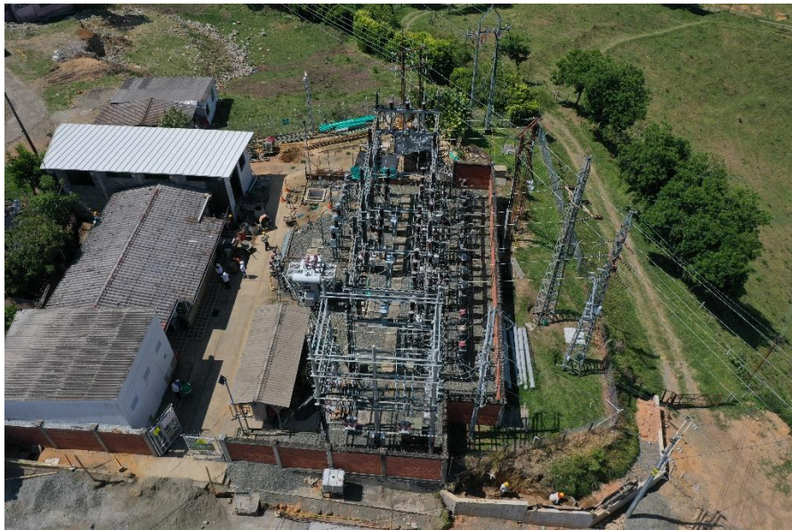
*Vista aérea Subestación Anserma (Anserma – Caldas)
