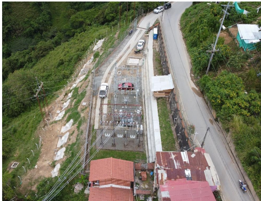
*Vista aérea Subestación El Dorado (Marmato – Caldas)
